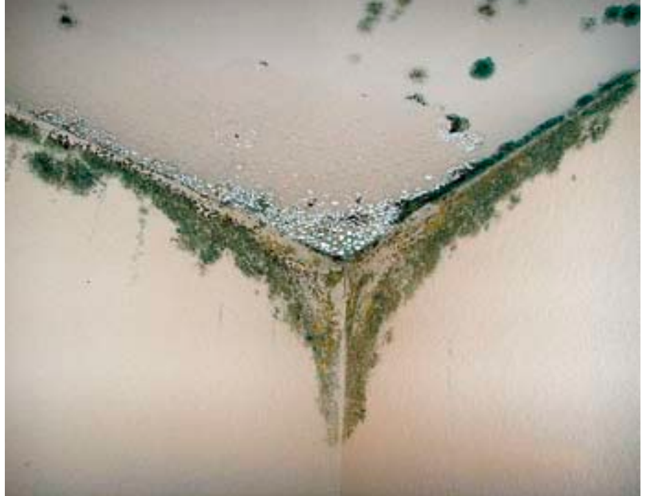
Um ein Schimmelpilzproblem dauerhaft in den Griff zu bekommen, müssen bauliche Mängel behoben werden.
